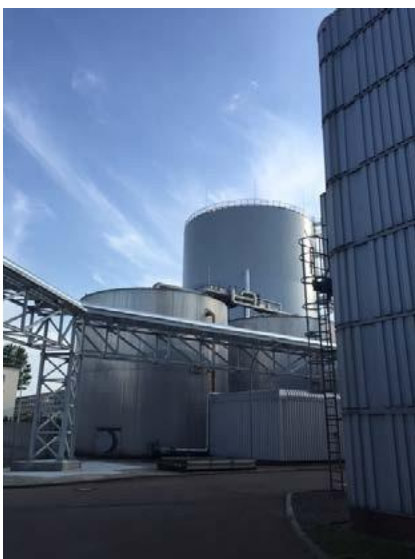
O novo sistema de armazenamento de calor na cidade de Dessau-Roßlau.
